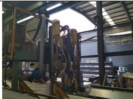
龙门焊焊接烟尘收集管
