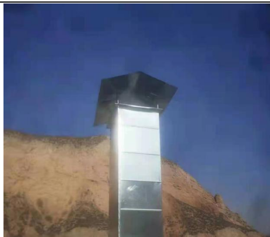
喷涂废气排气筒
